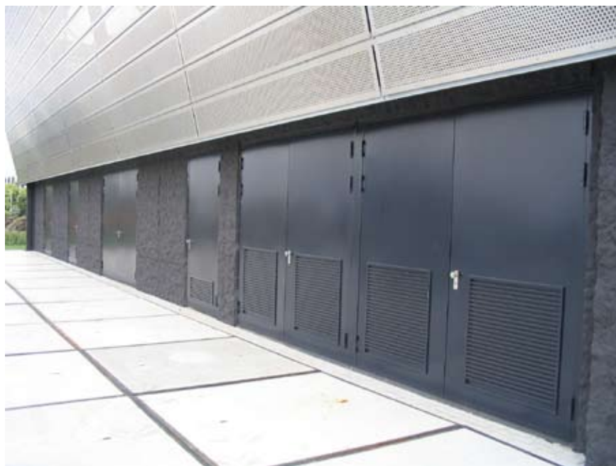
Portes MB dans une station de pompage
