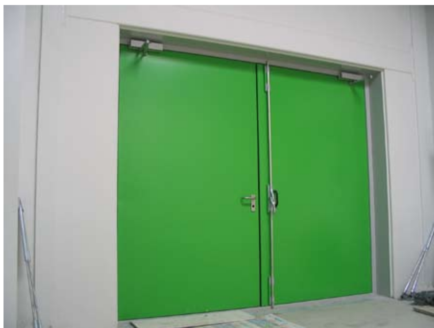
MB deur in een technische ruimte
