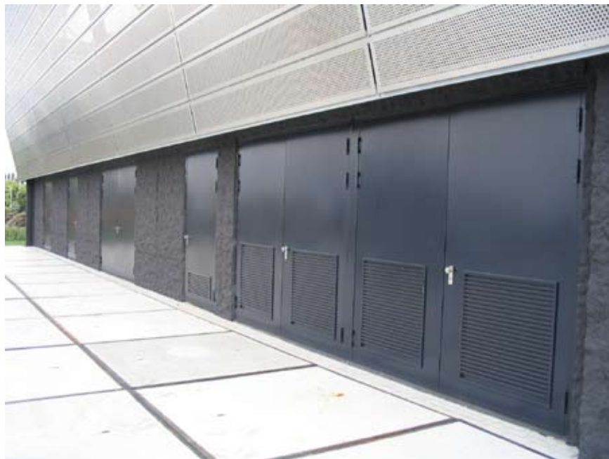
MB deuren in een pompstation
