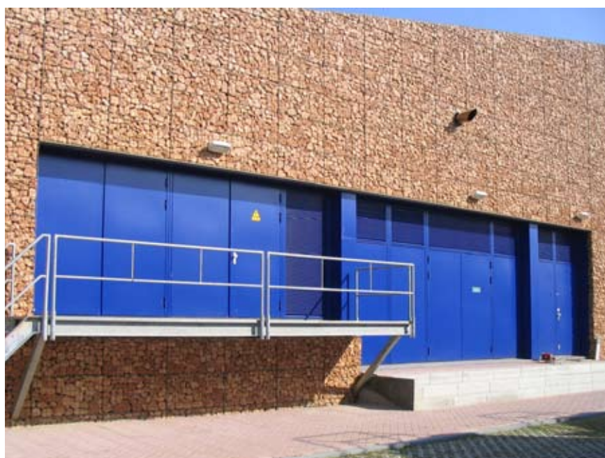
Portes de transformateur Centrale de traitement d'eau Vitens, Corle
