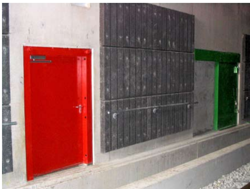
Tunneldeuren tunnel Giessen
