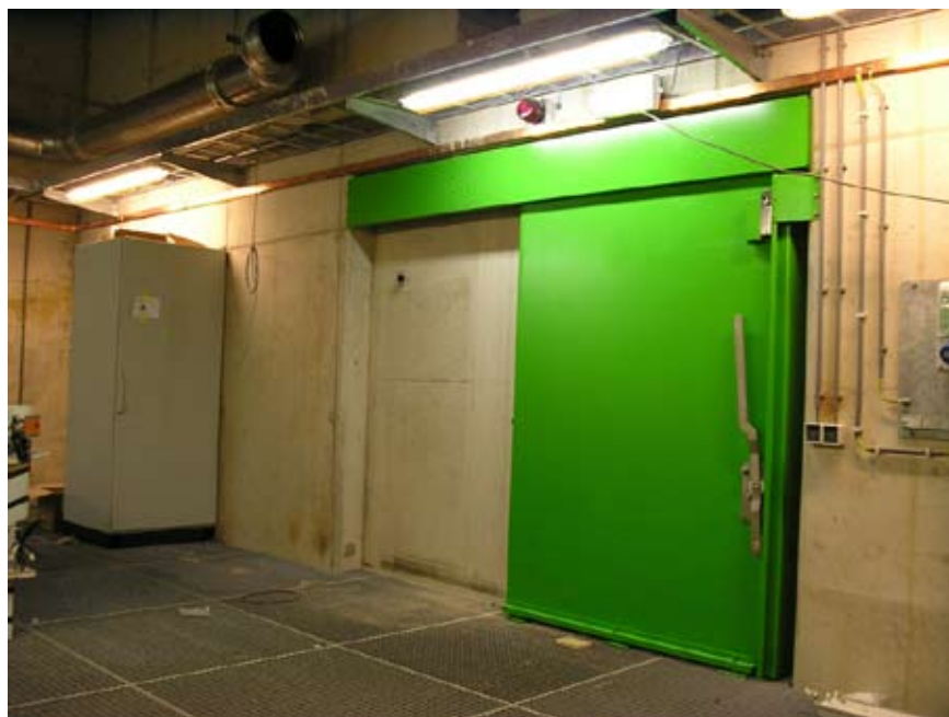
Tunneldeur Betuwelijn (schuifdeur)
