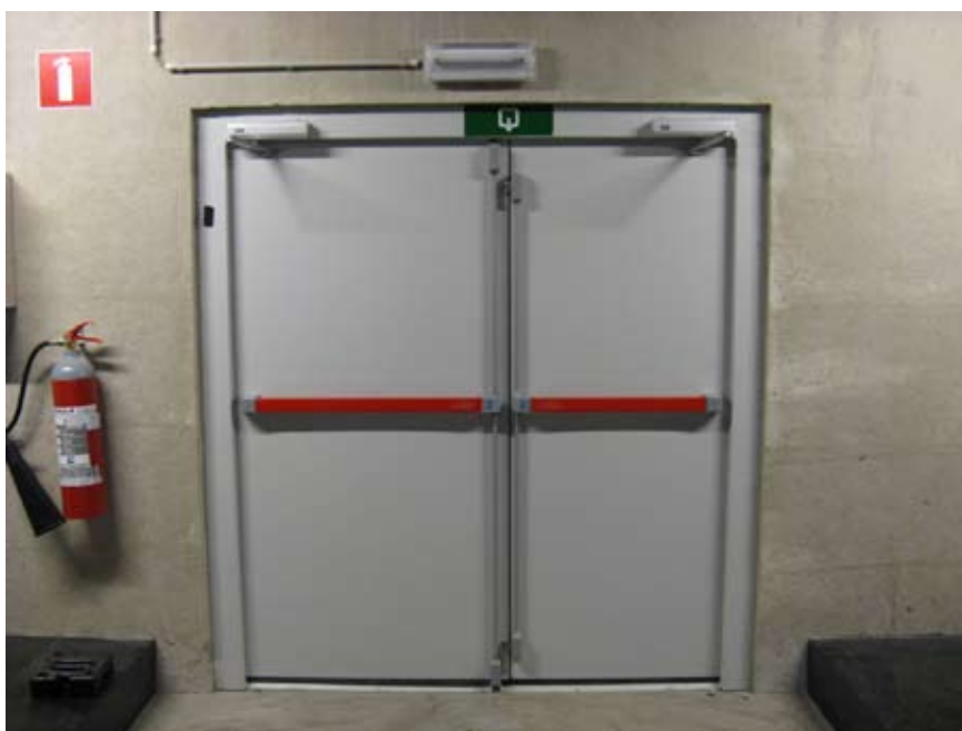
Porte de secours Videohouse Vilvoorde (BE)
