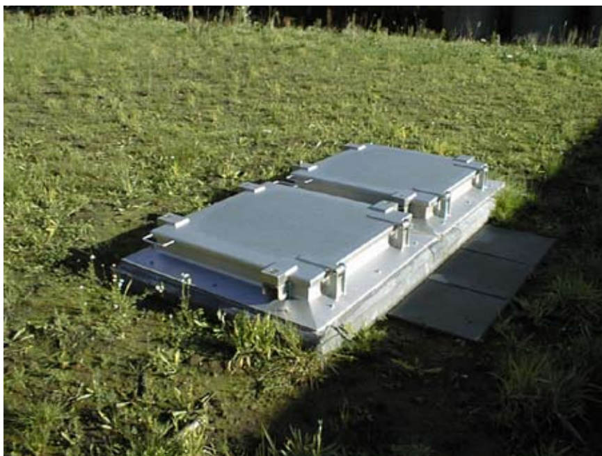
Waterdicht luik, Pompstation Dinxperloo (NL)
