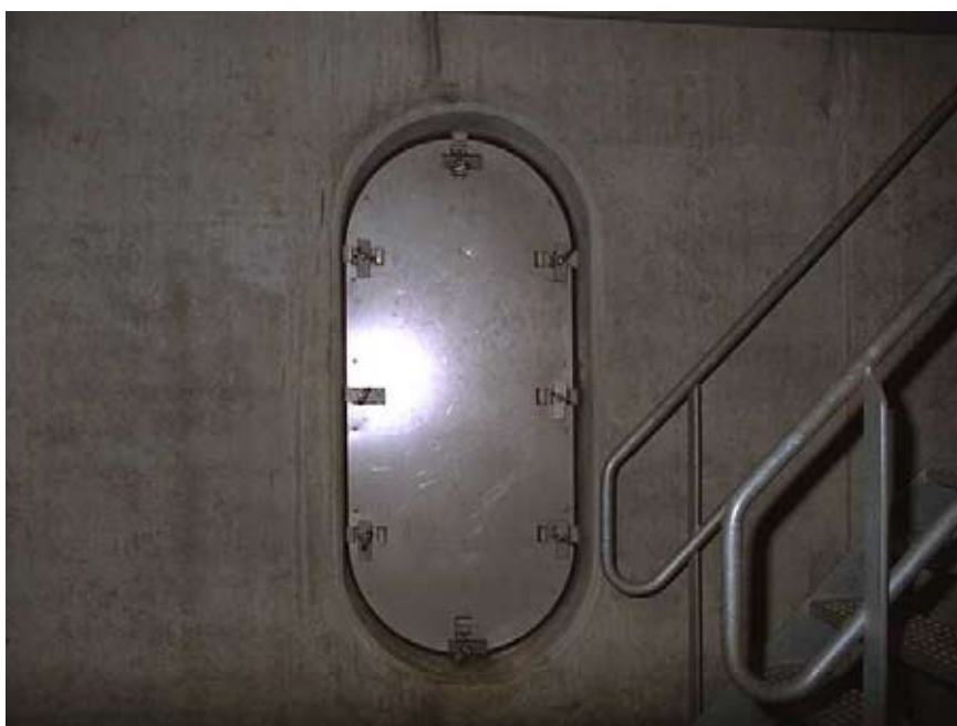
Waterdichte deur, Pompstation Nieuwland (NL)
